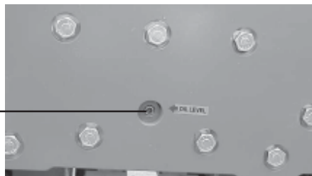
Figura 9. Revisando el nivel de aceite del vibrador
